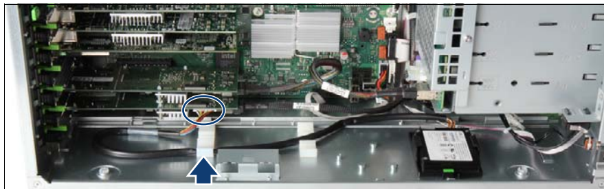
図 63: 例 : 1 つのコントローラへの 1 つの BBU ケーブルの接続
