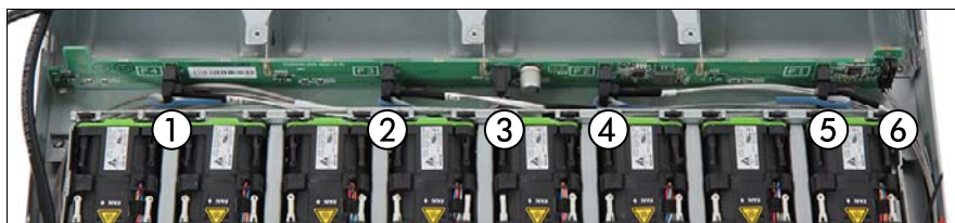
図 81: ケーブルの 3.5 インチ HDD バックプレーンへの接続
