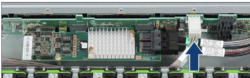
図 69: HDD バックプレーンへの電源ケーブルの接続
