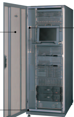
スタンダードラック (40Uラック)
