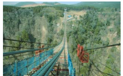
メインケーブル設置の様子。工事開始は2004年6月、完成は2006年10月
