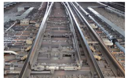
在来線と新幹線の軌道が合流・分岐するポイントを担う、三線分岐器★
