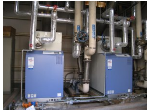
省エネボイラー装置(協和工場)
