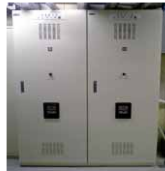
空調用冷却水送りポンプ インバータ制御盤
