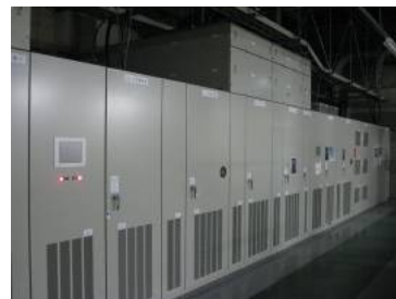
電気二重層キャパシタ設備
