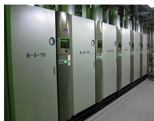
貫流ボイラ導入
