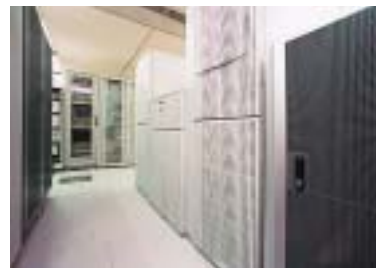
サーバールーム
