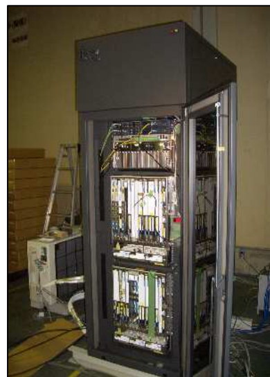
図 11 実機（通信装置）搭載写真
