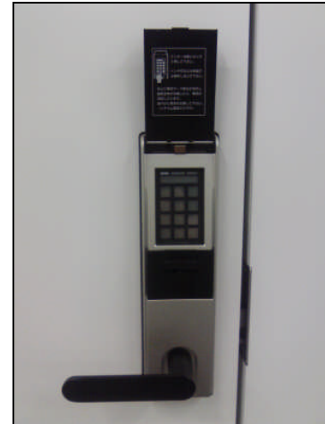
図8 サーバルーム電子錠
